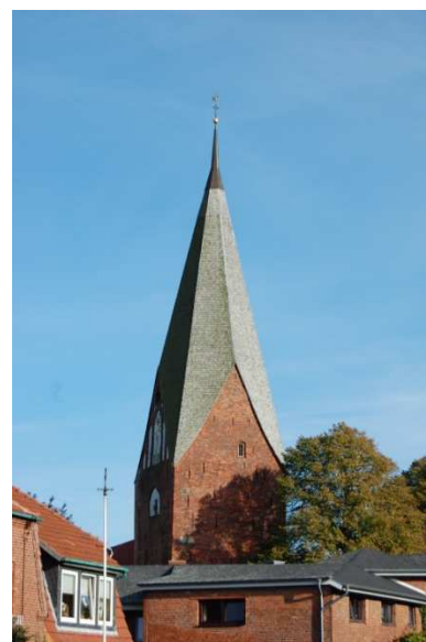
Dringende Sanierung erforderlich – Turm der St-Jürgen-Kirche zu Gettorf
